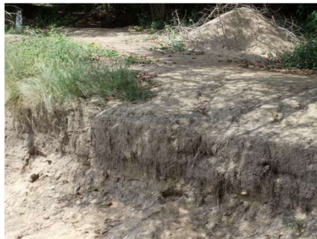
Photo 2 : Erosion des berges à Dékamè
